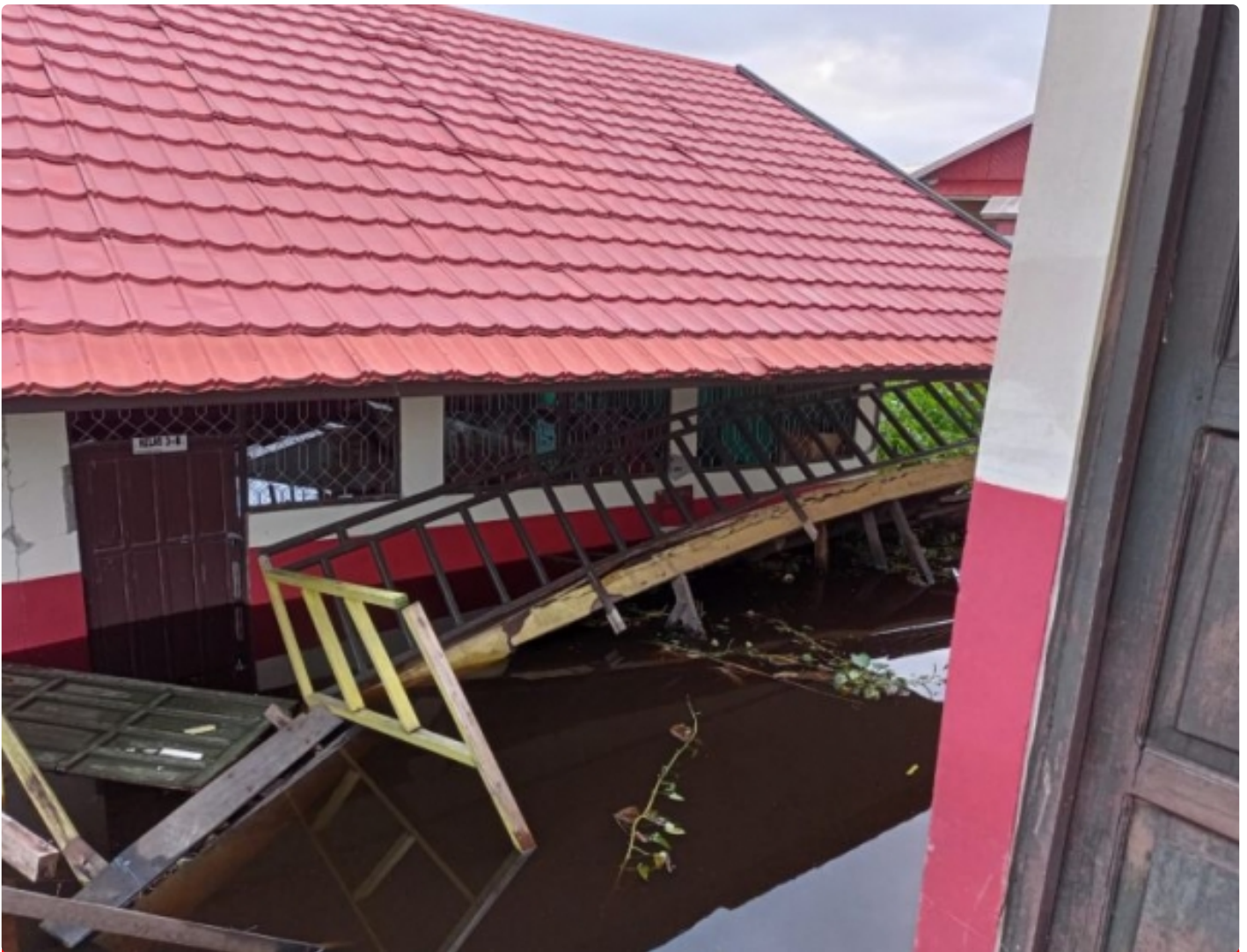
Bangunan SDN 14 Palangka Raya yang ambruk
